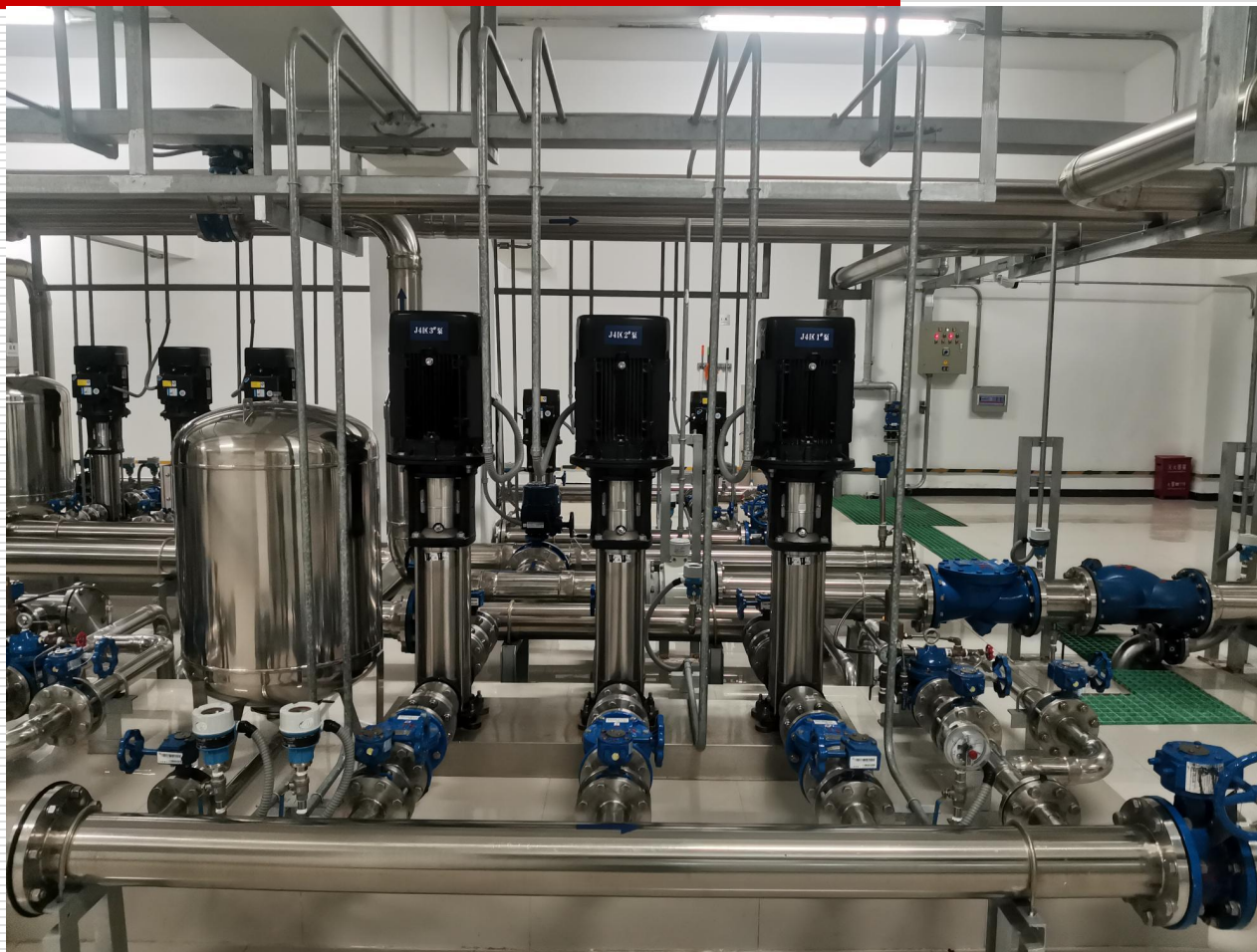
全变频供水泵
