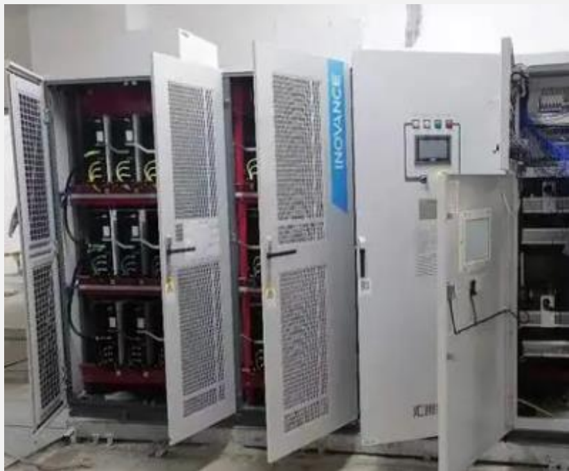
↑ 整机线路检查
