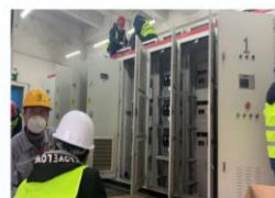
中高压变频器-智光高压变频器改造
