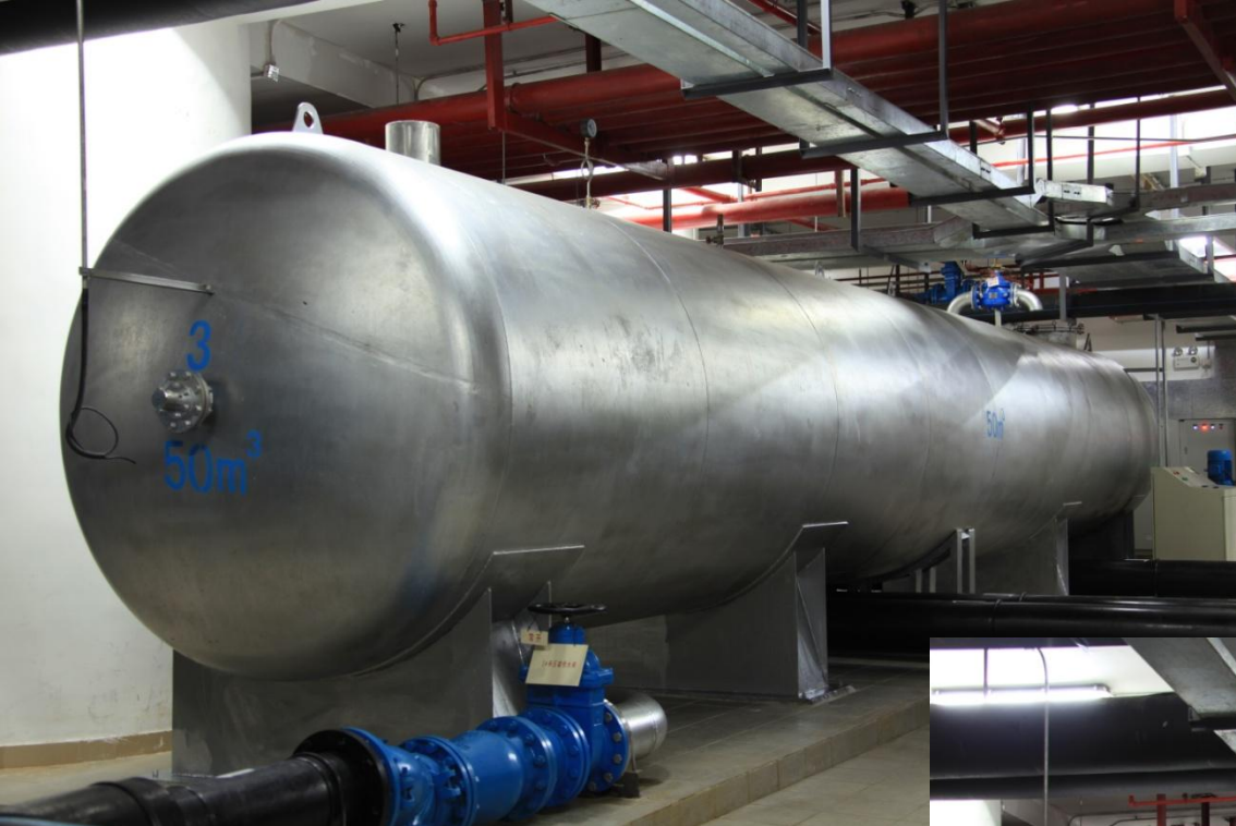
二次给水前置设备承压罐
